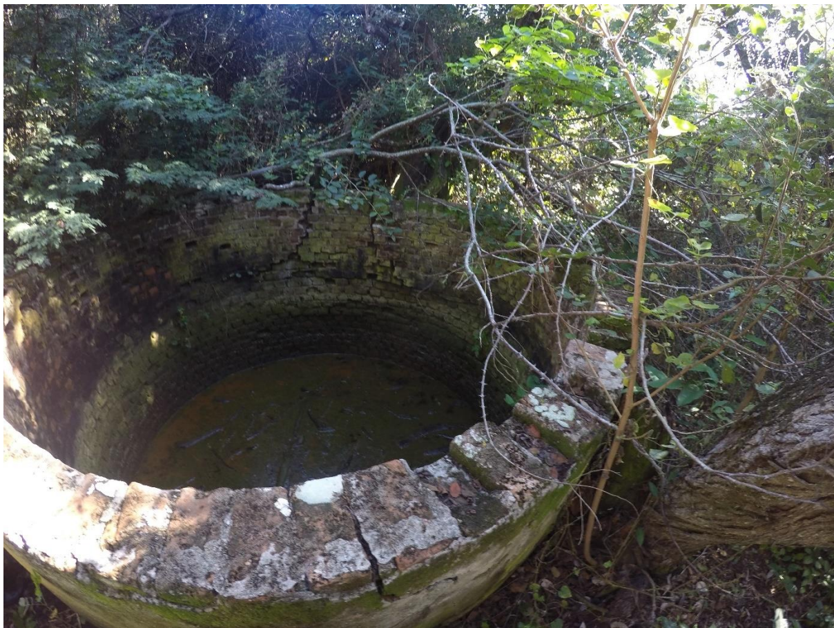
Figura 46: Registro fotográfico do Poço da Bomba atualmente.
