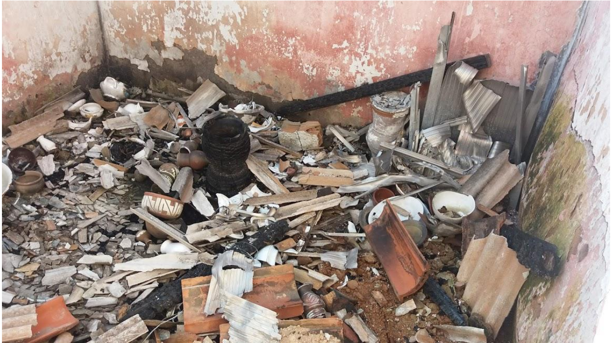
Figura 8. Cômodo do terreiro destruído. Fonte: Foto do autor
